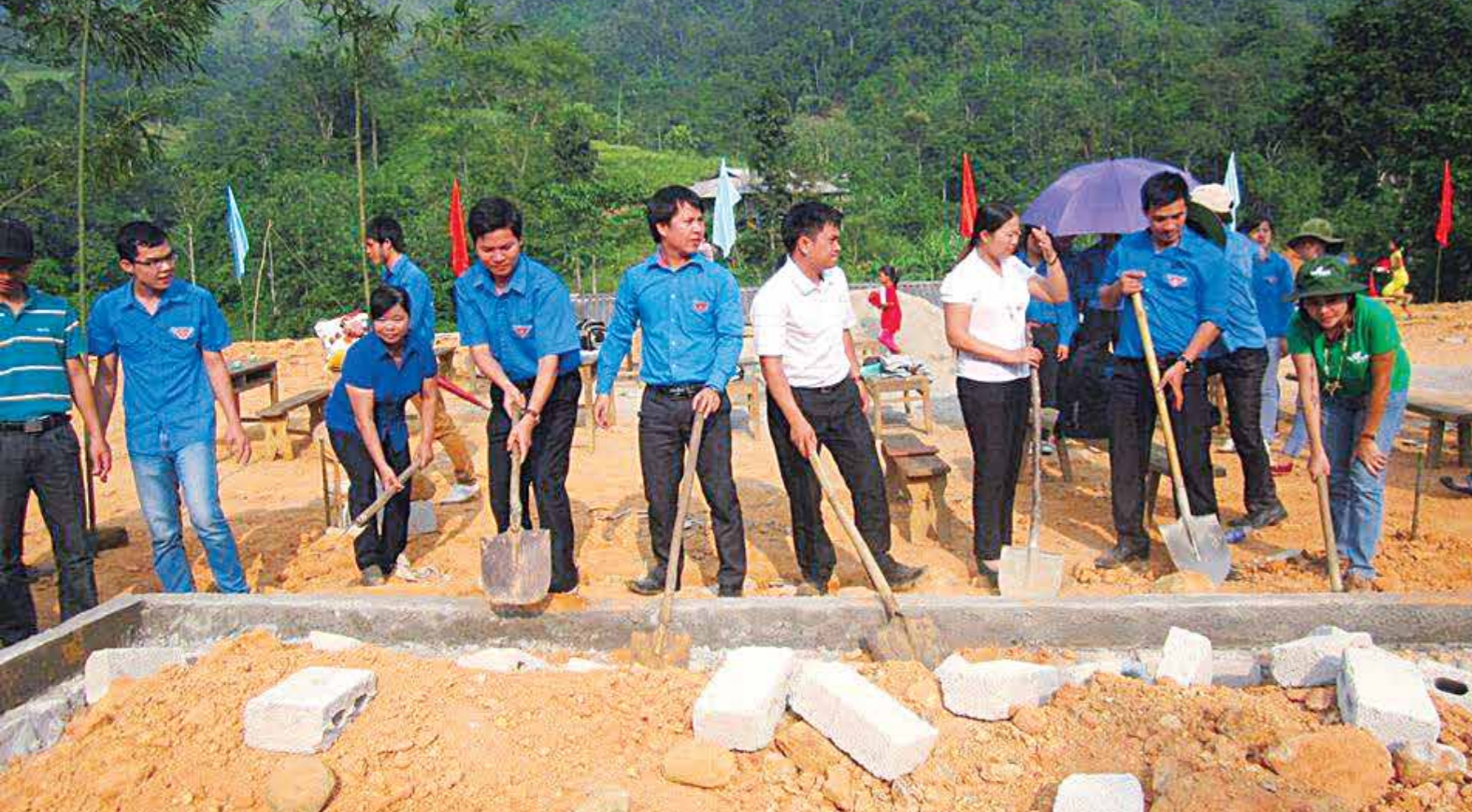
Tình nguyện viên chung tay lát nền cho ngôi trường mới / Volunteers joined in making ground for the new school
